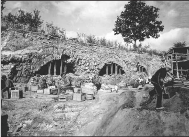
Укрепление откосов Замковой горы и освобождение древних стен от напора земли. Гродно, 1930-е гг.
